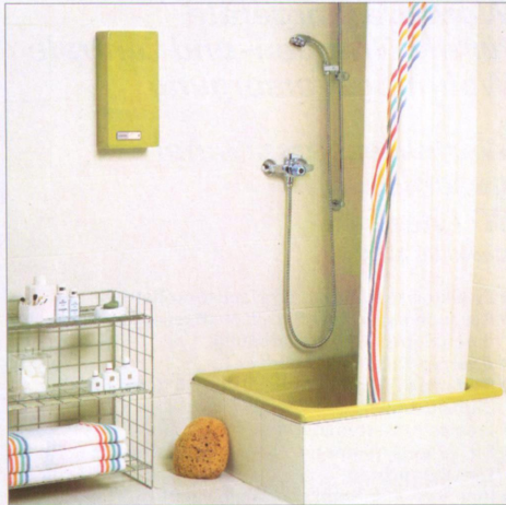
Durchlauferhitzer mit moosgrüner Dekorhaube für die Versorgung einer Dusche.
