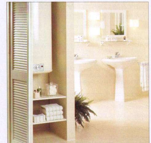
150 Liter Wandspeicher – im Badezimmerschrank eingebaut.
