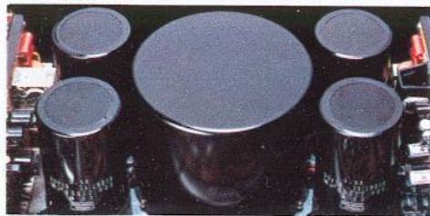
Leistungsstarker Ringkerntransformator des SX-1250.
